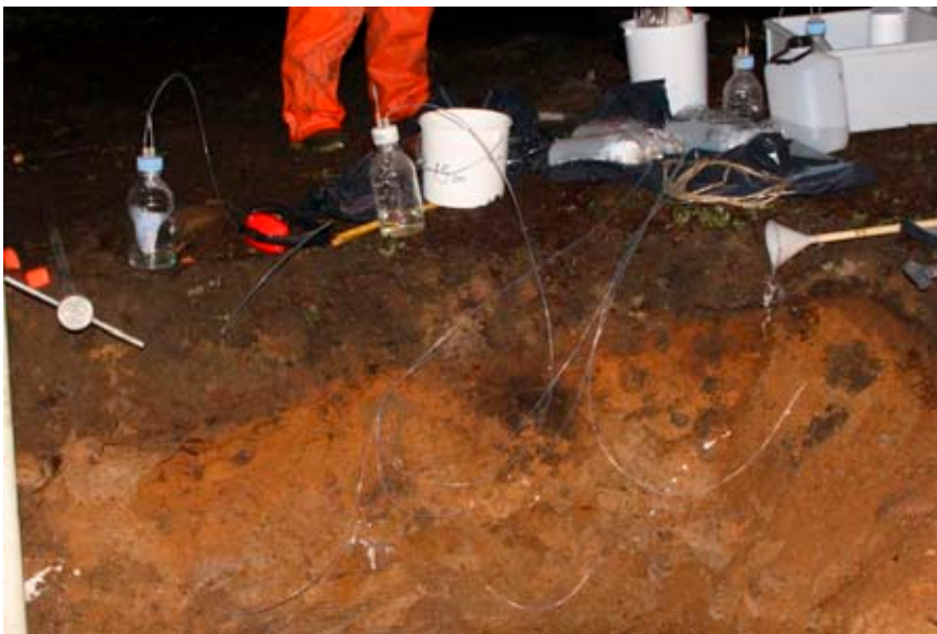
Figur 15. Installerade markvattenprovtagare i IVL Tö 3
