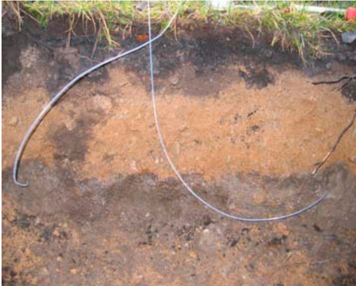
Figur 22. Installerade markvattenprovtagare i finkornigt lager i IVL Gr 2.
