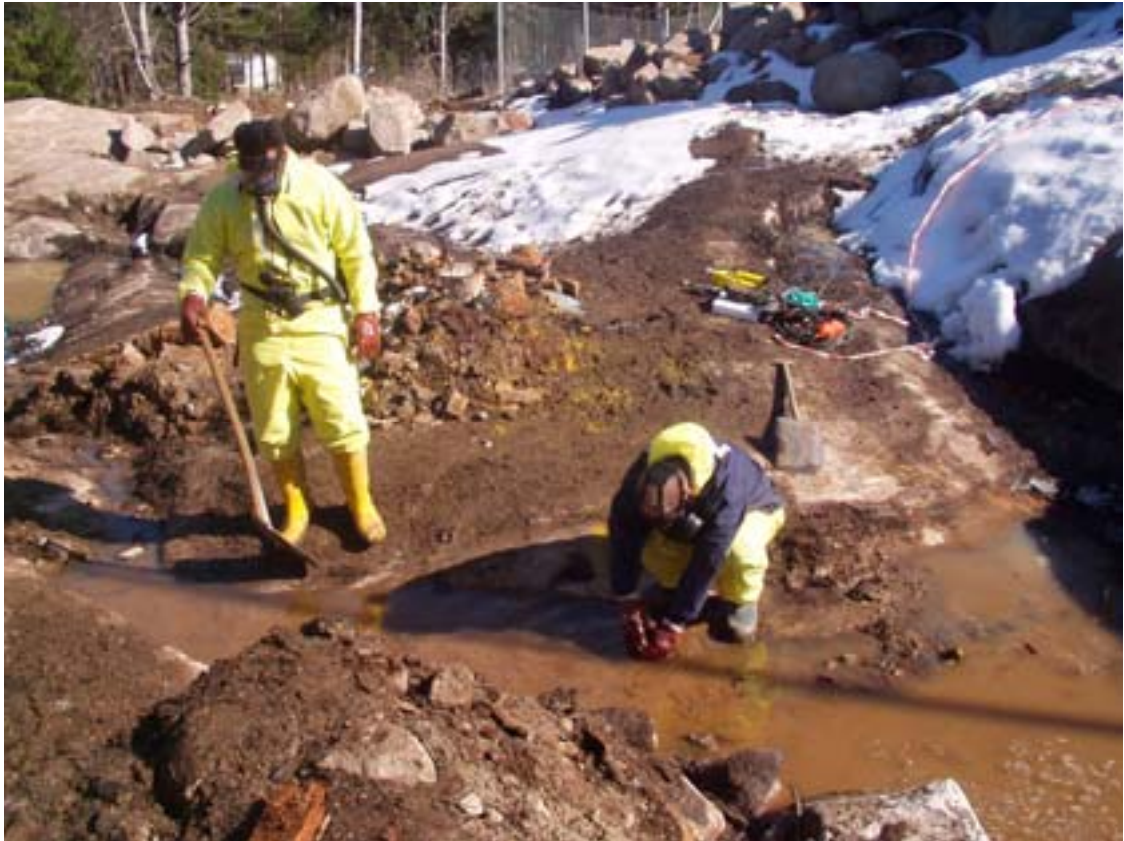
Figur 2-4: Utförandekontroll vid sanering av f d deponi i anslutning till f d Försvarsmaktsrelaterad försöksverksamhet. Specialutbildad personal arbetar i helskyddsdräkt med friskluftsmask. (Källa: Johan Helldén AB och FOI NBC-skydd).
