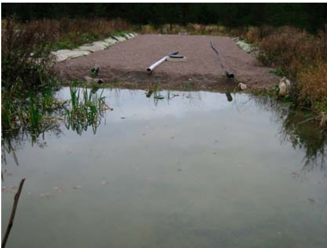
Figur 2-3: Exempel på passivt markfilter som har anlagts nedströms ett förorenat markområde för att hindra spridning/läckage av metallförorening i samband med schaktning av förorenad jord. (Källa: Johan Helldén AB)
