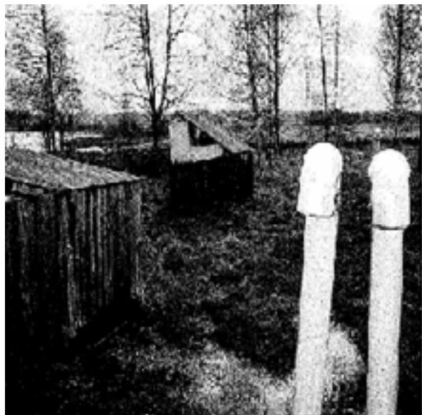
Bild 11. Markfilter vid Gunnita f d impregnering. Filtret är anlagt som en markbädd/"jordkulle" dit vattnet pumpas. Inloppet sker genom två fördelningsbrunnar med isolerade trälådor som skydd. De synliga rören är luftningsrör som ska motverka uppkomst av reducerande anaeroba förhållanden och därmed risk för bildning av arsenikväte (Bildkälla: Carina Lippel, Kils kommun).
