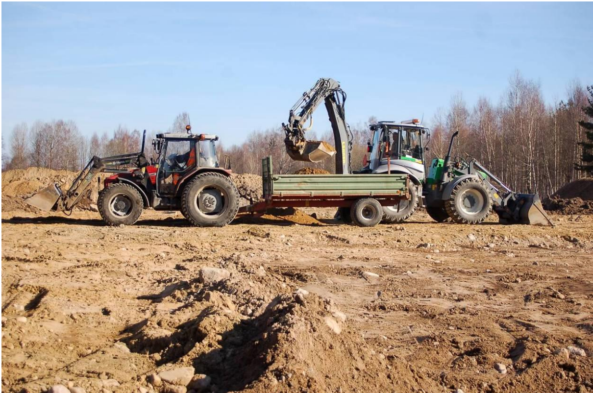
Området förvandlades till ett grustag. Delar av materialet såldes och finsand, mager jord och grusmaterial fördes på. Foto från 3 april 2009.
